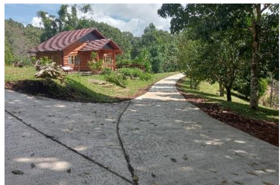
การก่อสร้างถนนคอนกรีตเสริมเหล็ก ระยะทาง ๒๕๐ เมตร
