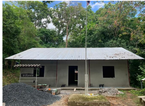
ดำเนินการซ่อมแซมอาคารสำนักงาน ชุดปฏิบัติการผาลาด โครงการพัฒนาพื้นที่ ป่าขุนแม่กวงฯ
