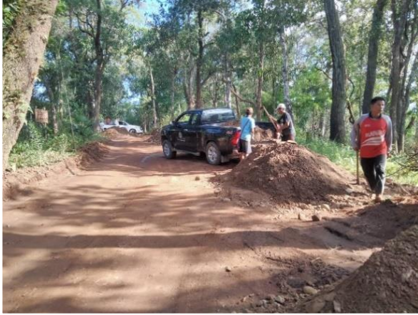
งานพัฒนาคุณภาพชีวิตปรับปรุงระบบส่งน้ำ ซ่อมแซมถนนคอนกรีต
