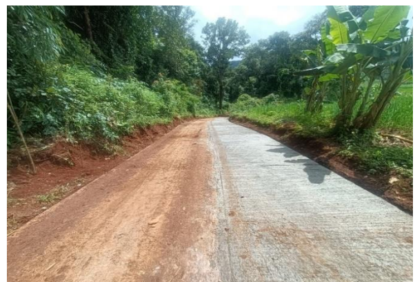
ก่อสร้างถนนคอนกรีต กว้าง ๓ เมตร หนา ๑๕ เซนติเมตร ระยะทาง ๑๕๐ เมตร
