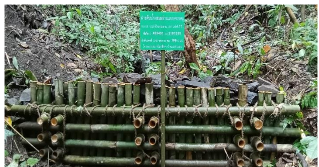
ก่อสร้างฝายต้นน้ำแบบผสมผสาน (แบบคอกหมู) ขนาด ๓ เมตร จำนวน ๒๐ แห่ง
