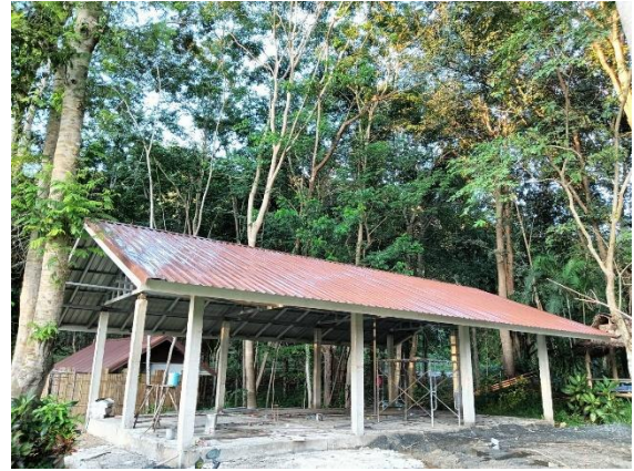
ดำเนินการก่อสร้างอาคารอเนกประสงค์ โครงการพัฒนาพื้นที่ห้วยลานอันเนื่องมาจากพระราชดำริ
