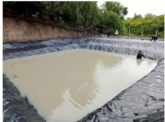
การจัดทำบ่อพักน้ำเพื่อการเกษตร จำนวน ๔ บ่อ
